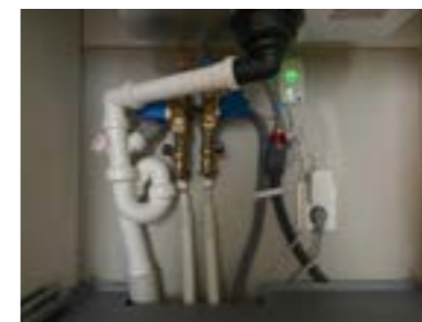
Vannlås kjøkken servant
