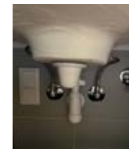
Vannlås servant bad med stoppekran
